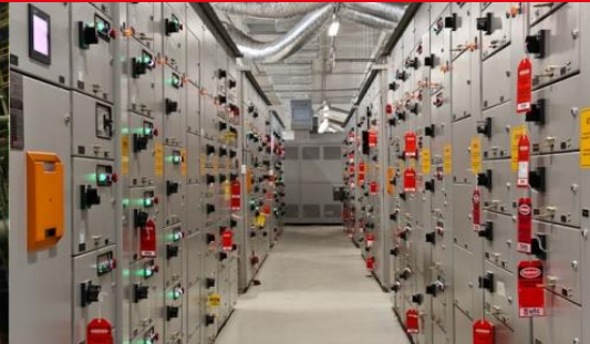
Equipamentos elétricos 27,412 toneladas
